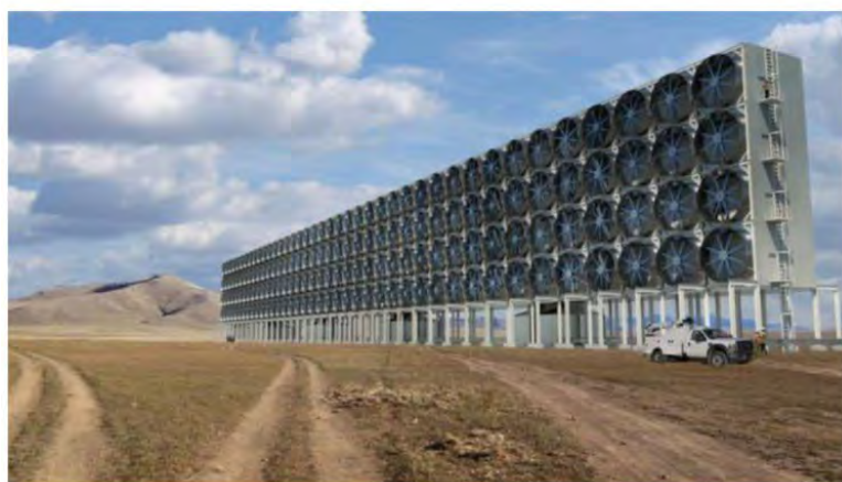
Die kanadische Firma Carbon Engineering will bis zum Jahr 2023 eine Anlage bauen, die eine Million Tonnen CO2 im Jahr filtern kann. Bild: dpa
